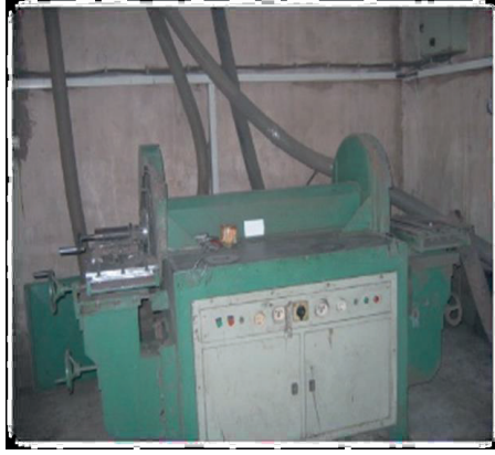
Şekil 1.3. Asbest tozu bulunan havalandırma sistemi parçası (Arseven, 2005).
