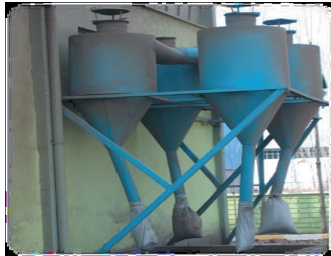
Şekil 1.2. Toz toplama silolarının yüzeyinde biriken asbest tozu (Arseven, 2005).
