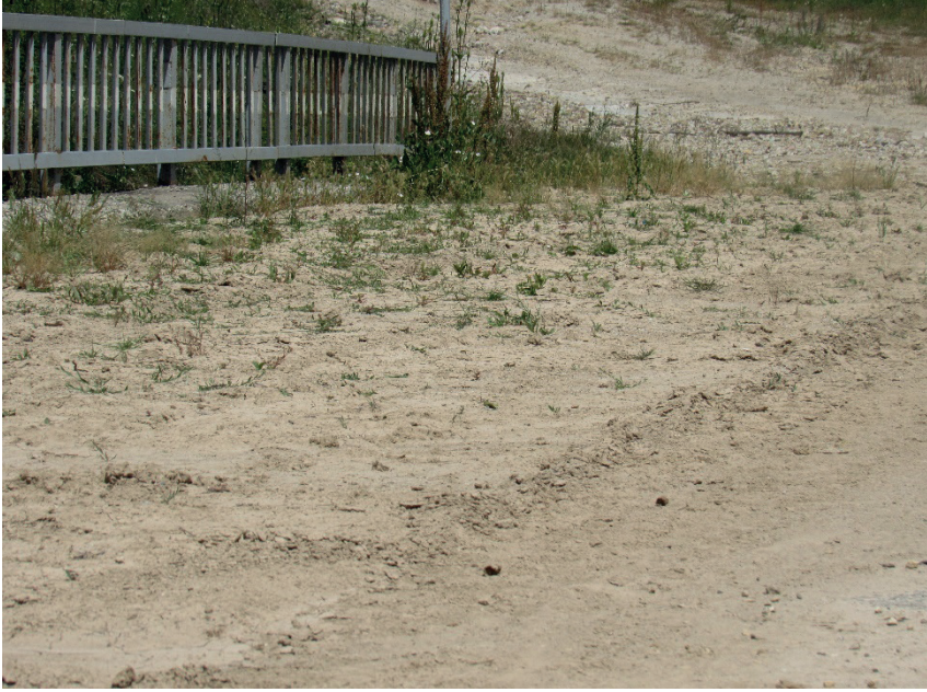
Fotoğraf 9. Uygulamalı jeomorfoloji problemlerinden erozyon-mühendislik yapıları arasındaki ilişkiye göre Baldıran Köprüsü'nün yüksek miktarda sediment taşınımı sonucu ikinci bir köprü inşa edilmiştir
