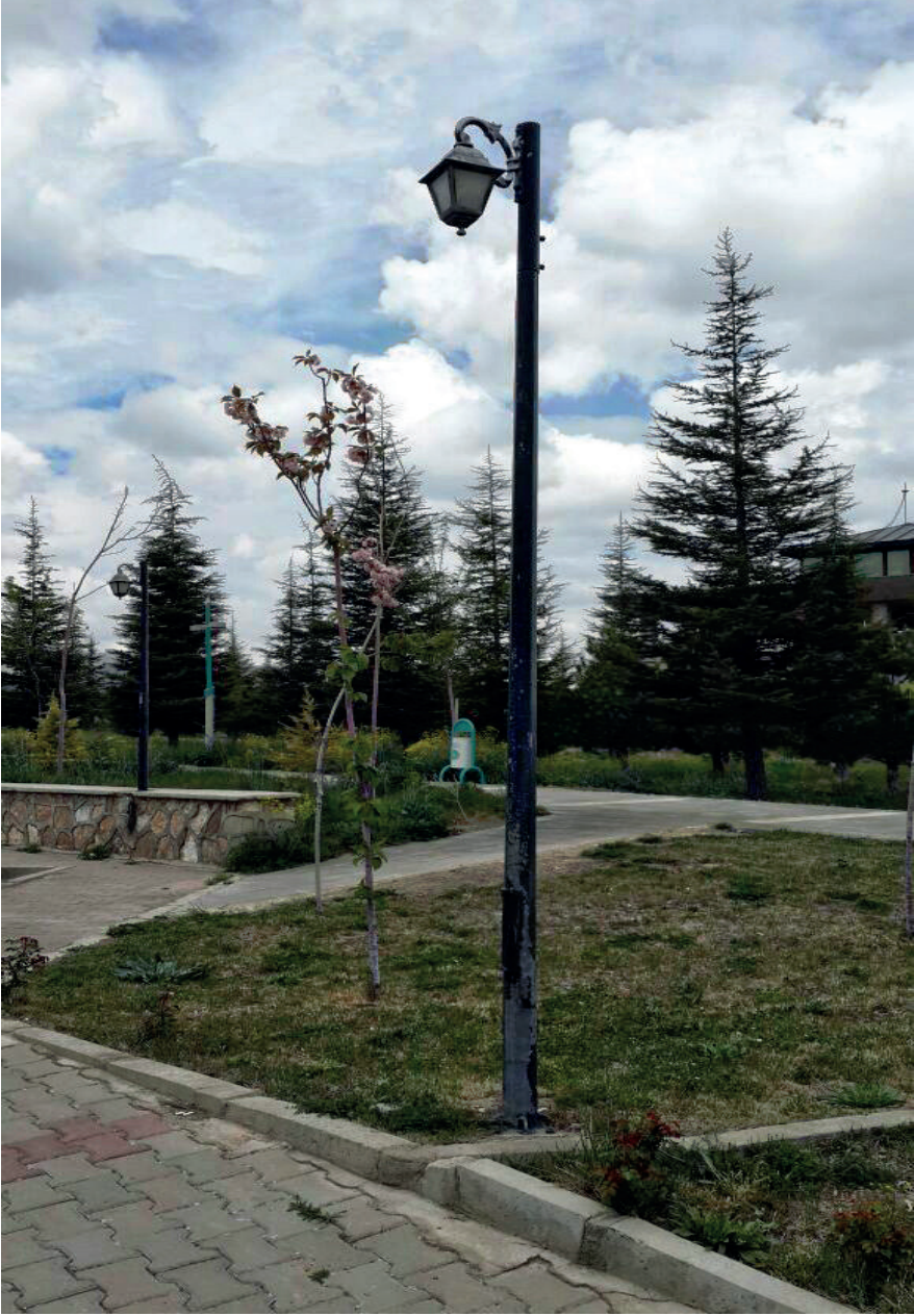
Şekil 9. Yerleşke yeşil alan aydınlatmasında kullanılan armatür-2
