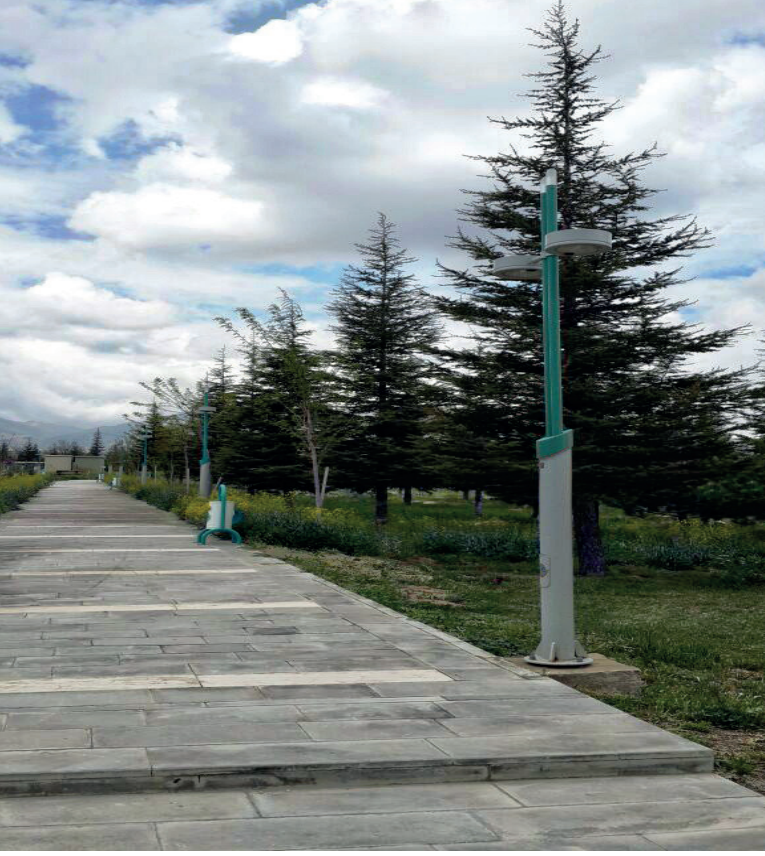
Şekil 12. Yerleşke yeşil alan aydınlatmasında kullanılan armatür-5
