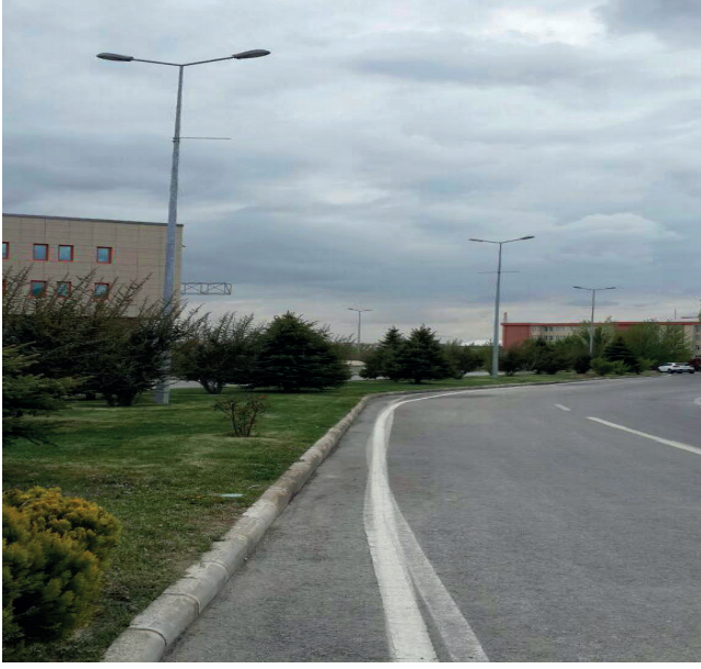
Şekil 2. Yerleşke anayol aydınlatmasında kullanılan aydınlatma direkleri ve armatürler - 1
