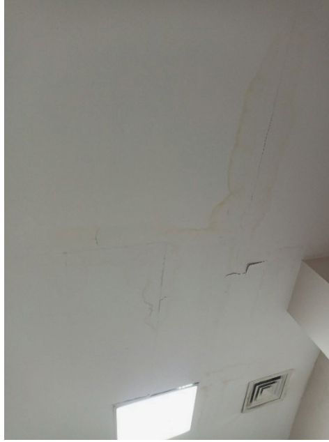
Şekil 5. 16. Tavanda sızıntı sonucu oluşan renk sararmaları
