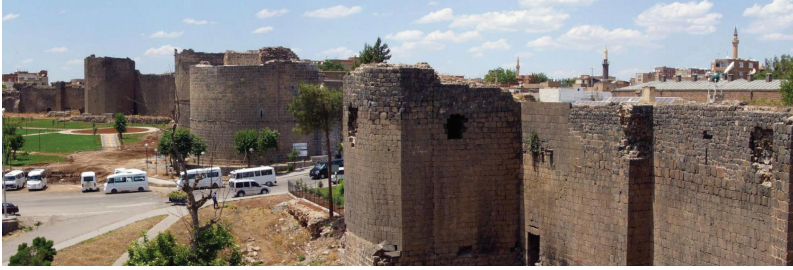
Resim 14. Surlarda bazalt örgü sistemi ve kaplama taşlarında tahribatlar (URL 3)
